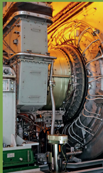
A turbina de combustão em Saint-Pierre (Ilha da Reunião)
