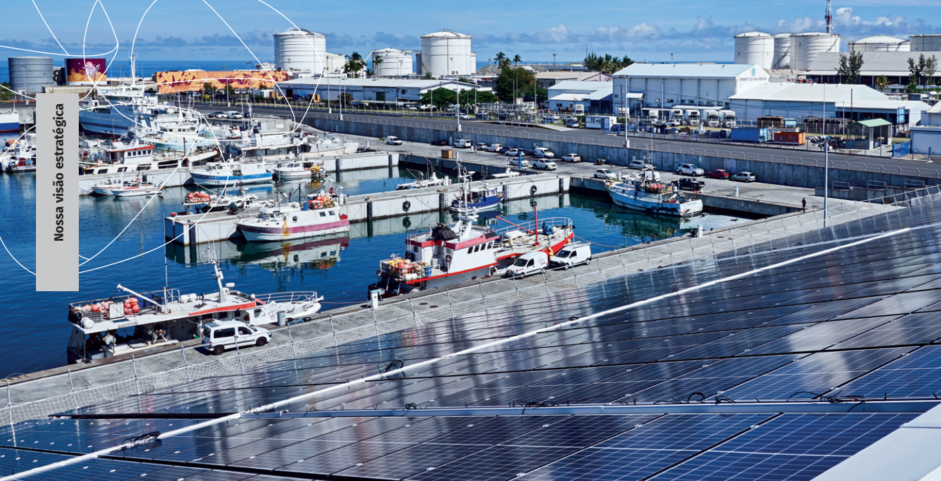
Unidade Fotovoltaica - Port Ouest, Ilha da Reunião
